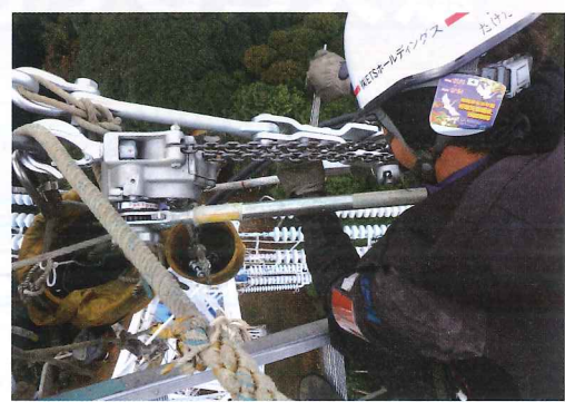
鉄塔と電線をつなぎとめる
